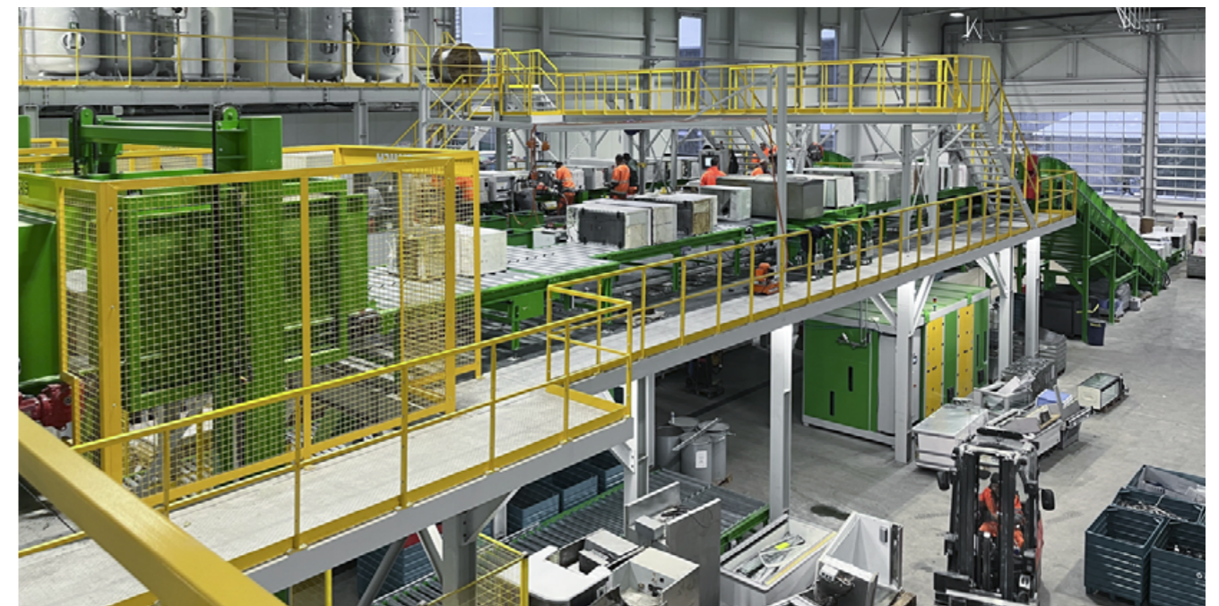
Installation de recyclage pour appareils frigorifiques Erdwich d'Immark AG Au centre: étage supérieur de l'installation avec stations d'aspiration. À gauche: sortie des appareils pour le niveau 2 de traitement, avec installation de production de N 2 à l'arrière-plan.
