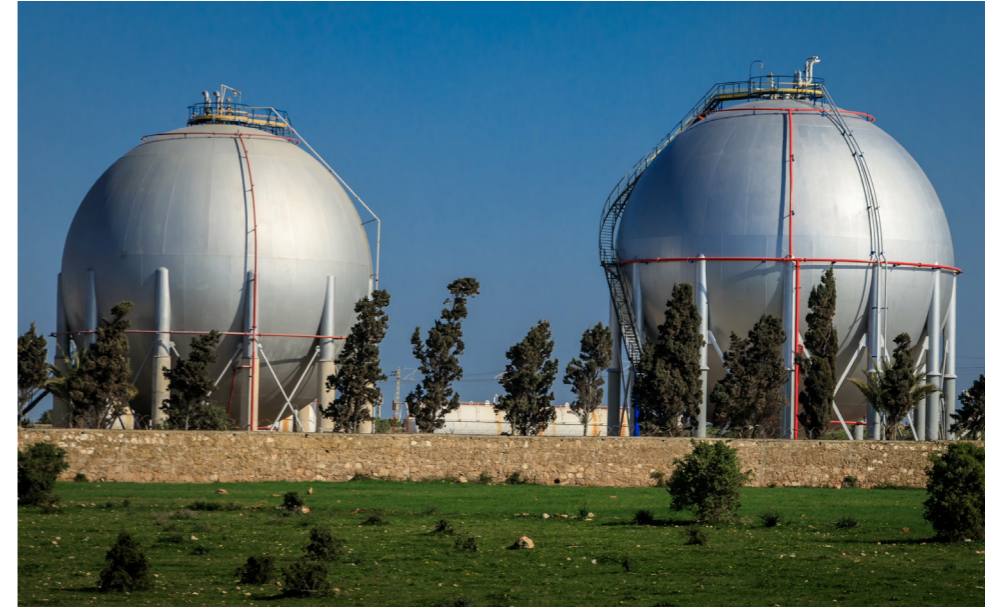
Abbildung 3: Typische Kugelgastanks für die Erdgaslagerung (Quelle: Adobe Stock)
